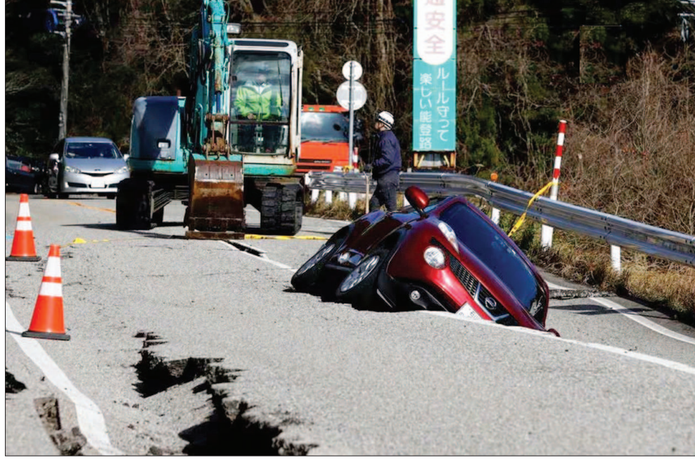
जापान में आये भीषण भूकंप के कारण सड़कों पर दरारें पड़ गयीं। ऐसी ही एक दरार में एक कार फंस गयी।
